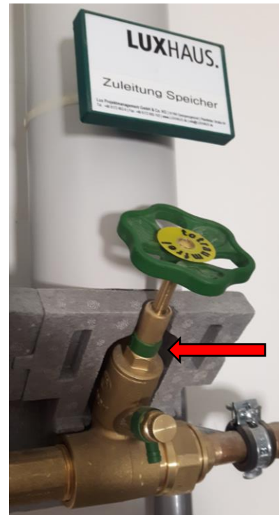
Abbildung 4: KFR-Ventil ohne Dämmblock, gekennzeichnet mit einem grünen Ring
