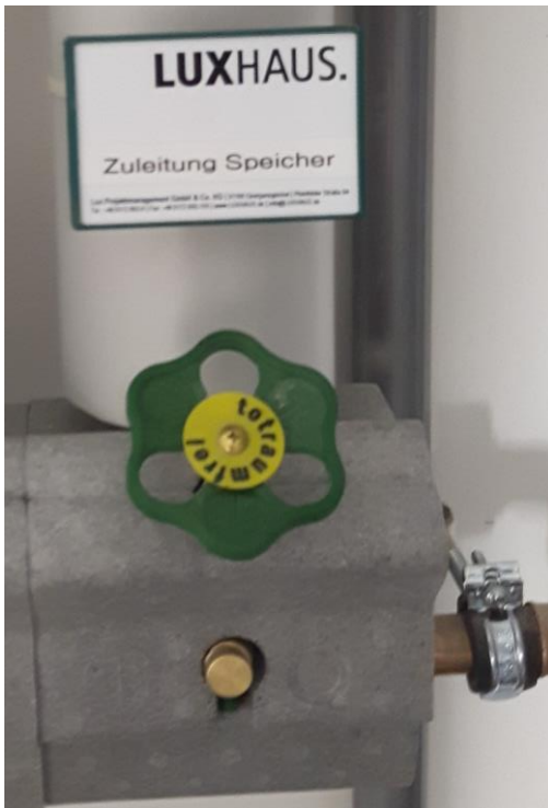
Abbildung 3: KFR-Ventil mit Dämmblock
