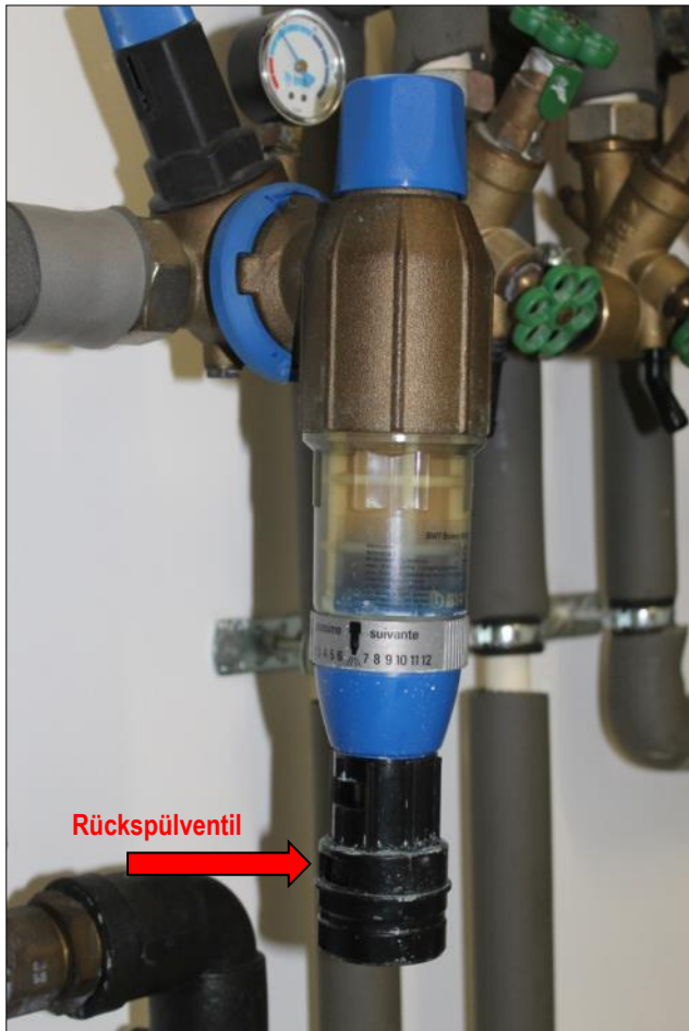
Abbildung 2: Wasserfilter eines Einfamilienhauses im Haustechnikraum
